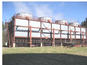
Градирня после реконструкции
